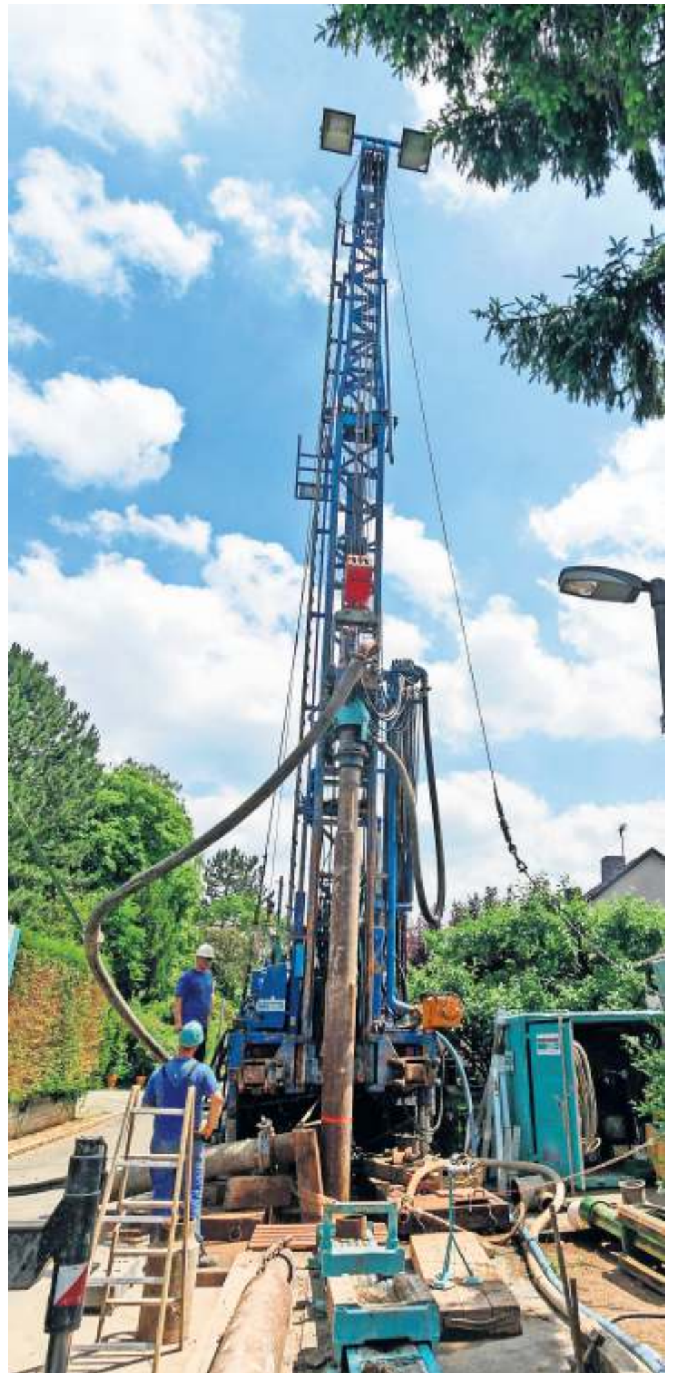
Bei einer Erkundungsbohrung ist in 59 Metern Tiefe Anhydrid gefunden worden. Wenn in die Schicht Wasser eindringt, bildet sich Gips – und die Erde quillt auf. Foto: factum/Archiv
