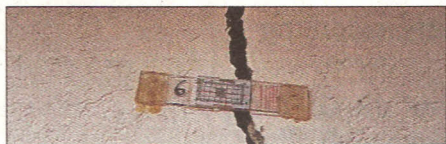
Erdhebungsschäden in Böblingen
